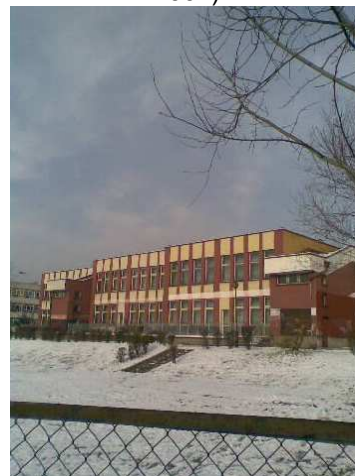
Foto. 3.10. Elewacja z płyty azbestowo-cementowej płaskiej, malowana (Ministerstwo Gospodarki, 2007)
