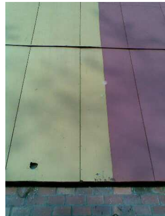
Foto. 3.8. Elewacja z płyty azbestowo-cementowej płaskiej, malowana (Ministerstwo Gospodarki, 2007)
